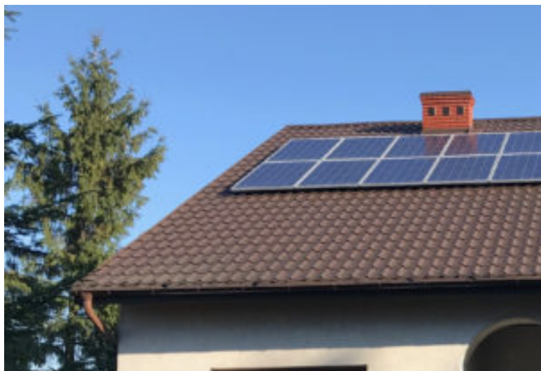
Instalacja fotowoltaiczna Vosti
