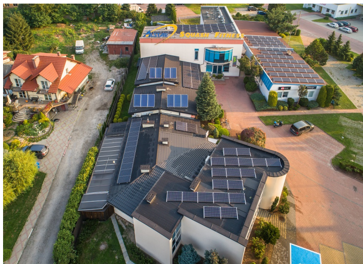
Instalacja fotowoltaiczna na płaskim dachu
