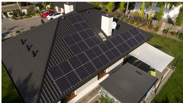
Instalacja fotowoltaiczna na dachu kopertowym
