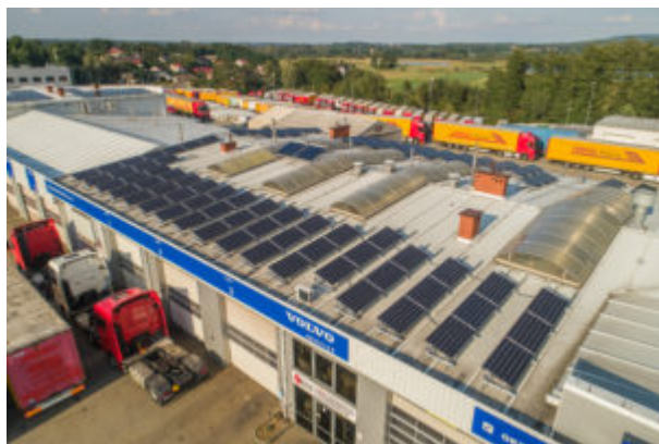
Instalacja fotowoltaiczna na płaskim dachu
