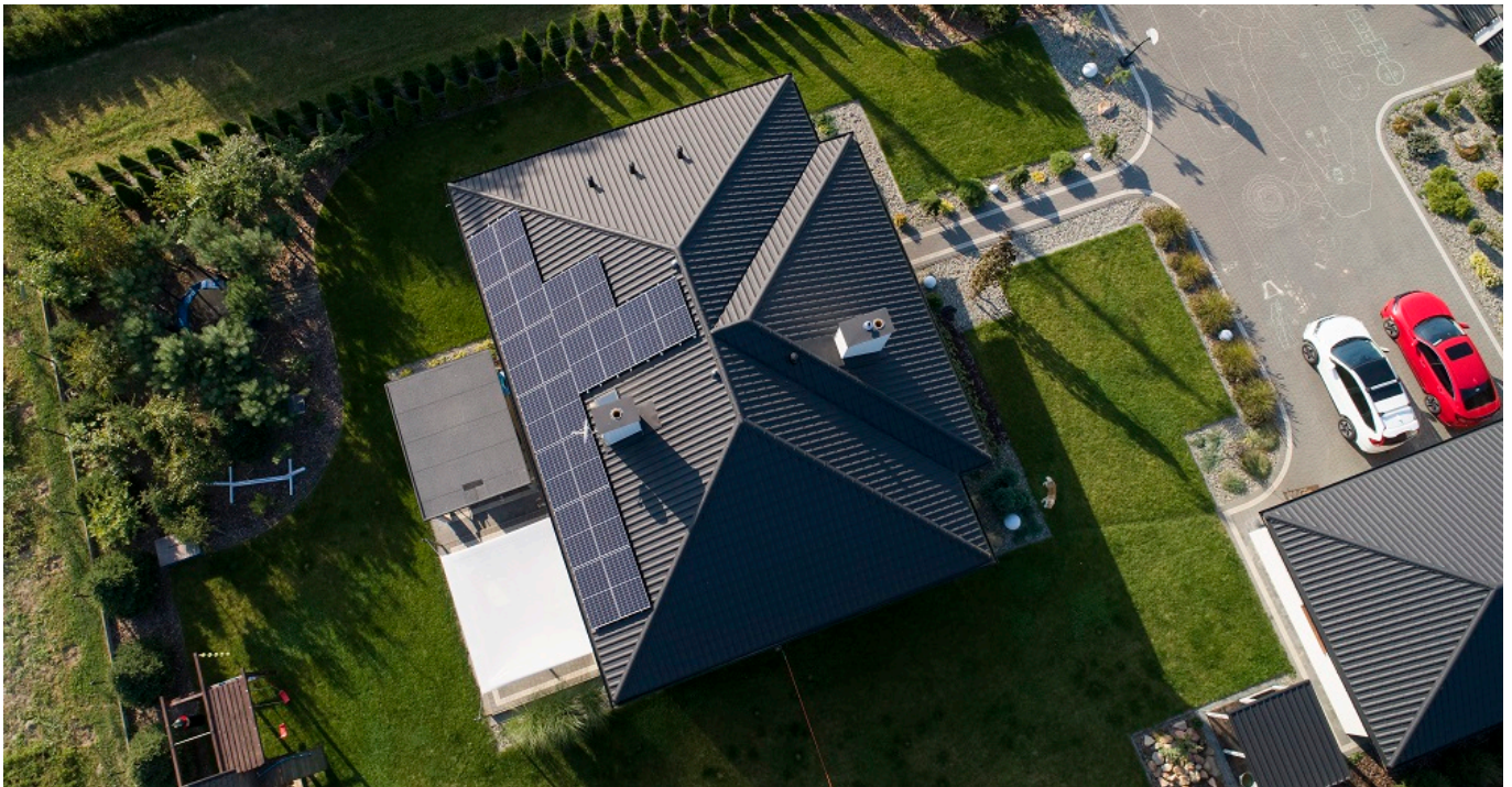
Instalacja fotowoltaiczna Vosti
